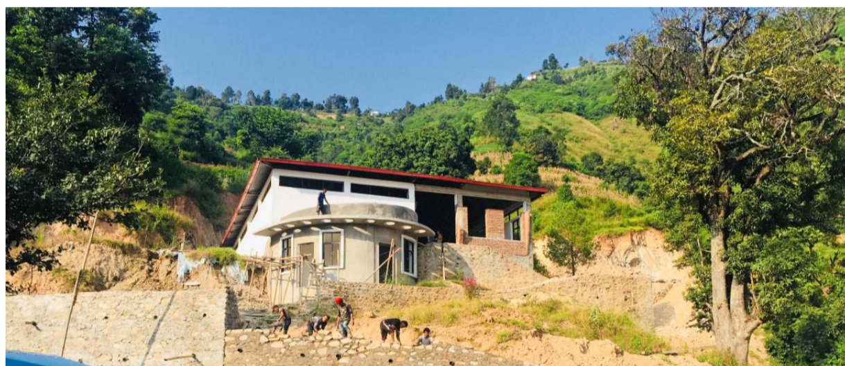
Das Bild zeigt die Baustelle für die Ausbildungswerkstatt in Nepal. Das Gebäude ist erdbebensicher gebaut. Im September soll die Ausbildung mit zertifizierten Trainern beginnen. Foto: privat
