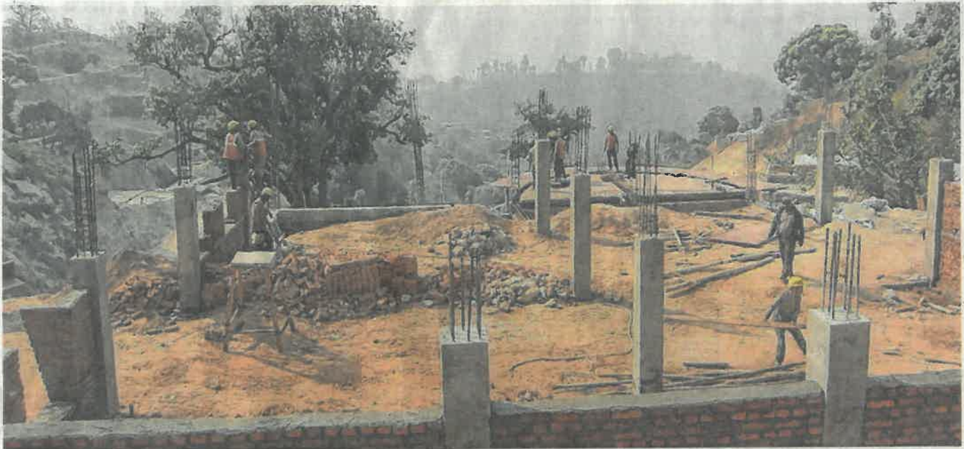
Erdbebensicher gebaut: Die Metallwerkstatt wächst. Die Baustelle liegt auf über 3000 Metern Höhe. Gesteerte Straßen gibt es nicht. Dies erschwert zwar die Transporte des Baumaterials aus dem Tal, doch von den umliegenden Dörfern aus ist die Schule gut zu erreichen. Foto: privat
