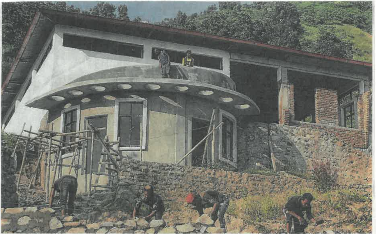
Eifrig arbeiten die Helfer daran, das Ausbildungszentrum in der Region Dhading zu bauen. Dort sollen junge Menschen in Holz- und Metallberufen ausgebildet werden.
